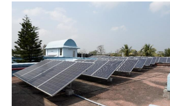
चित्रा 2.16 प्रशासन भवन की छत पर सोलर
